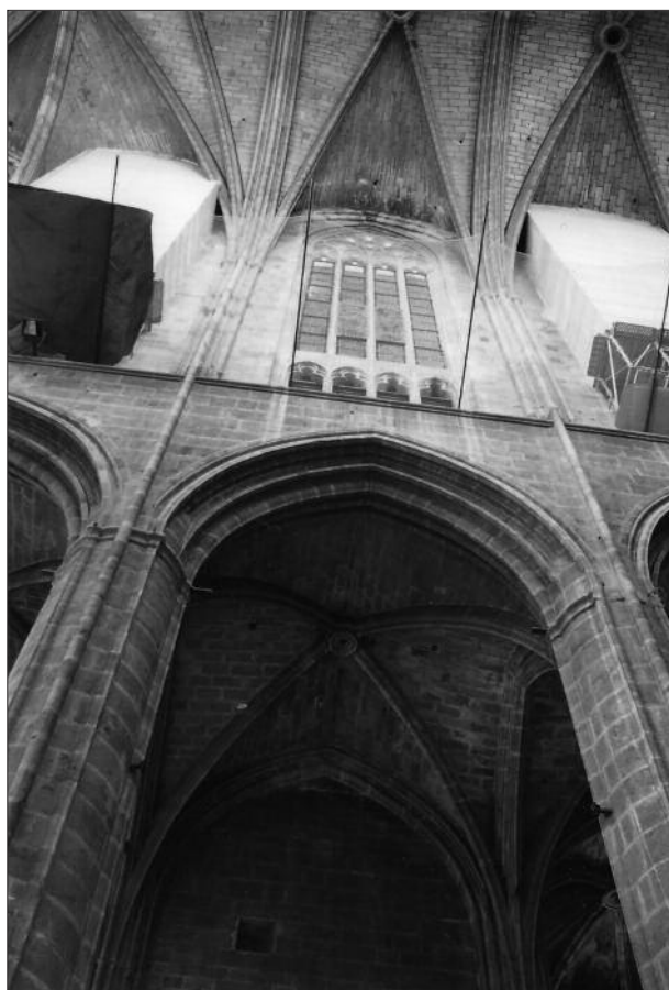
FIG. 17. CATHÉDRALE SAINT-JUST DE NARBONNE. Vue de l'élévation d'une travée de chœur. Cliché A. Béa.
