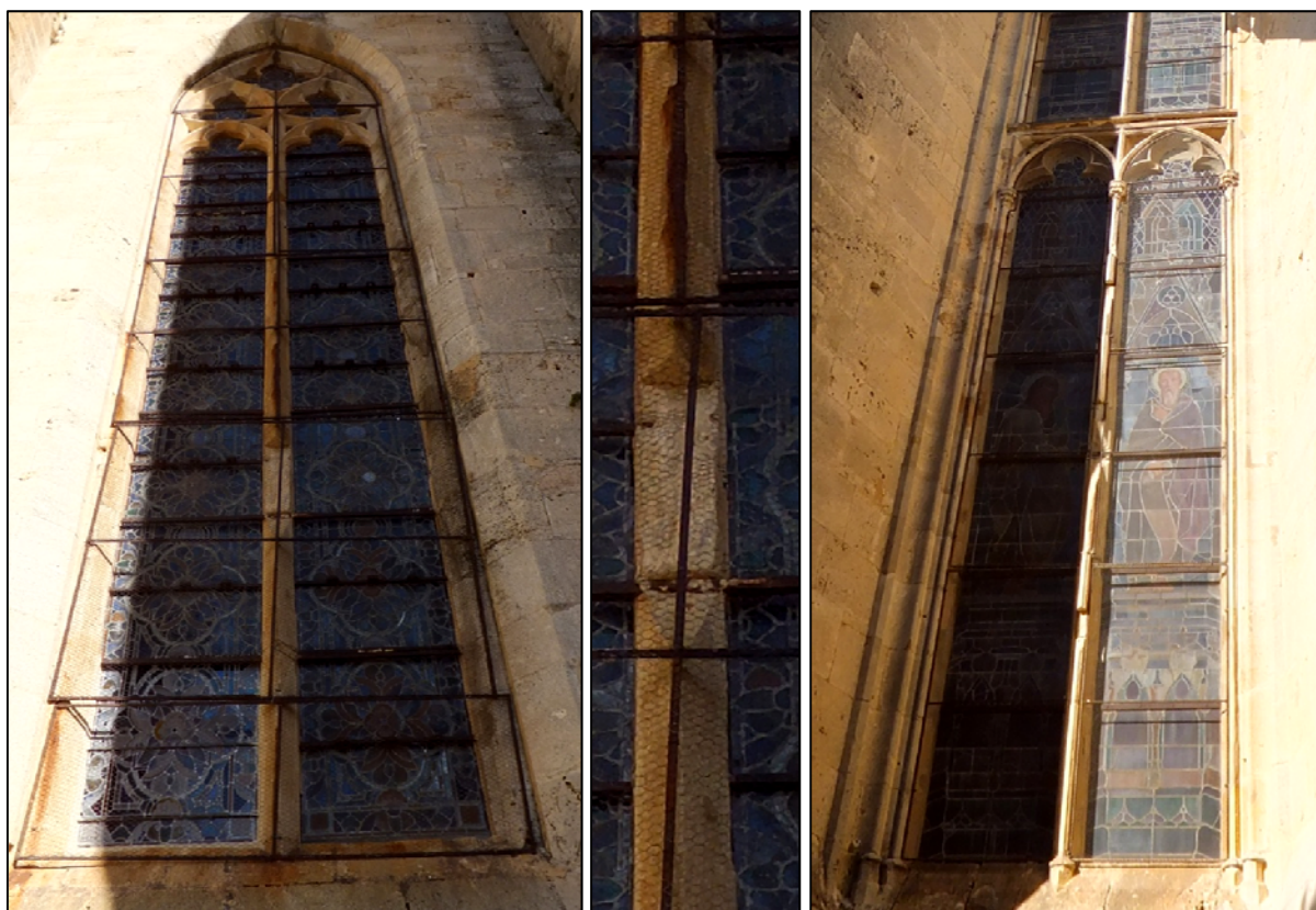
Photos 1,2 et 3: Eclatement des meneaux sur les baies de la façade Sud (gauche) et du chevet (droite).
